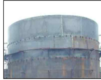
Fly Ash Silo
