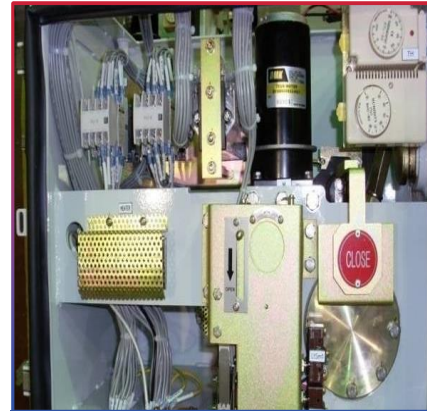
362kV GIS MOTOR TYPE
